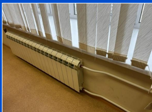
Обновленные радиаторы системы отопления здания
